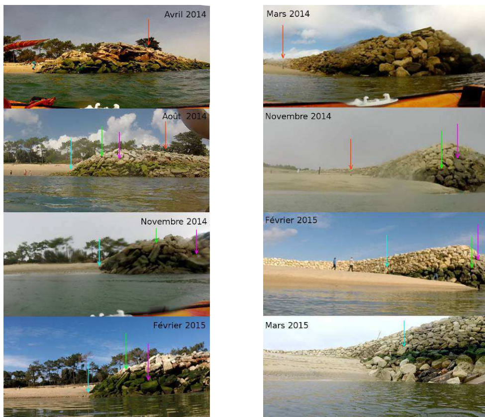
Figure 10. Montage chronologique de 4 vues des défenses ; à gauche : extrémité de l'ouvrage bordant le nord la plage du Tram suite à son effondrement ; à droite : ouvrage constituant l'extrémité sud de la défense de la façade est du cap Ferret. Les flèches repèrent des blocs communs aux prises de vue.
