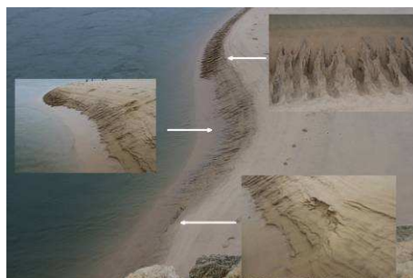
Figure 11. Photographie de différentes formes de suintement de la plage sud, en situation saturée et de forte pente. Instabilité ponctuelle sur la photographie superposée du bas.
